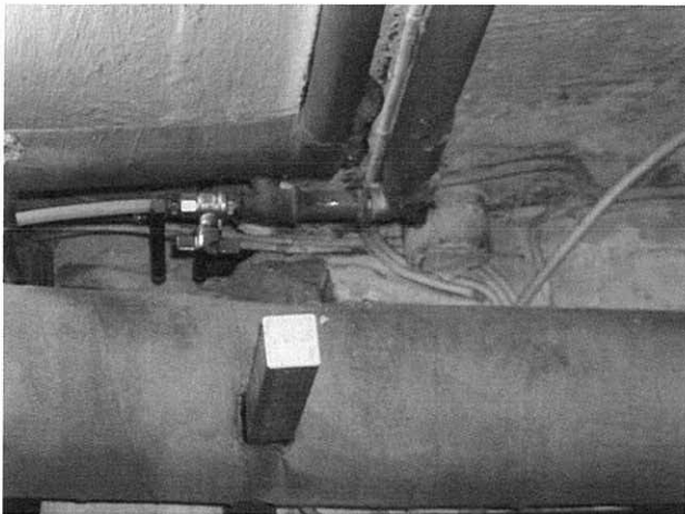
Billede 1: Tæret galv. fitting og overgang til kobber
