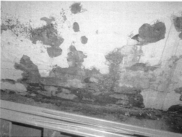
Billede 7: Fugt i kælderydervæg.
