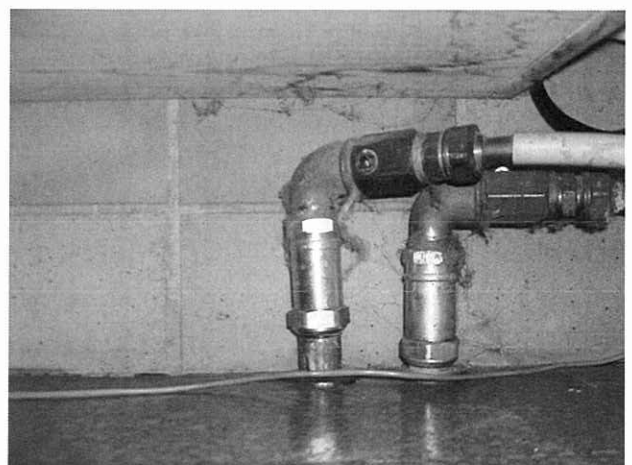
Billede 12: Direkte overgang Galvaniseret rør til kob
