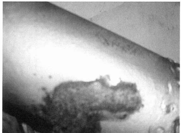
Billede 2: Tæret faldstamme i kælder.
