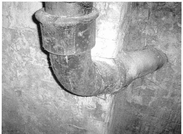
Billede 4: Tæret faldstamme i kælder.
