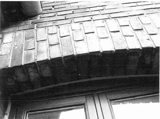
Billede 15: Udvaskede fuger gårdfacde.
